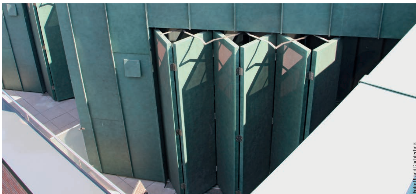
Klempnertechnische Herausforderungen ergaben sich auch bei den kniffligen Details zur Einfassung der Faltstores. Die Stores sind mit gelochtem, vorpatiniertem Kupferblech Oslo verkleidet.
